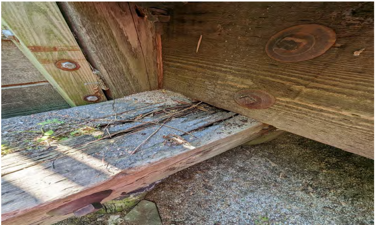
Rotten Cap Bent 9
